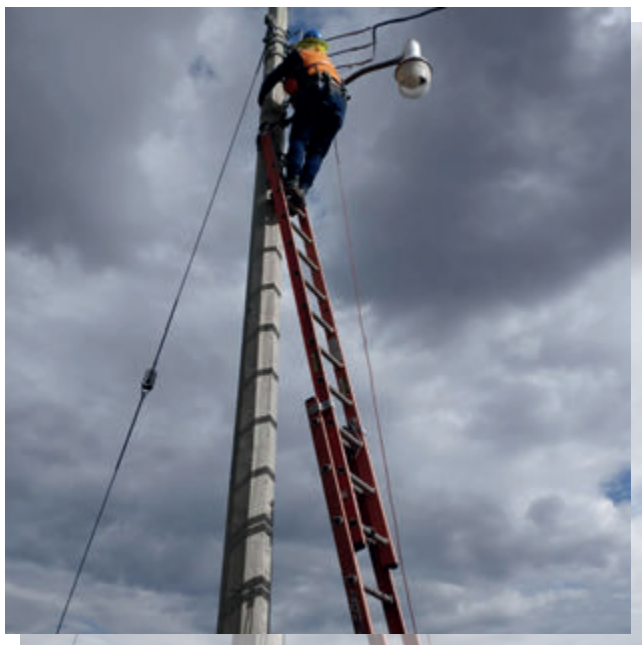
Rehabilitación del Alumbrado Público, Ojo de Agua.
